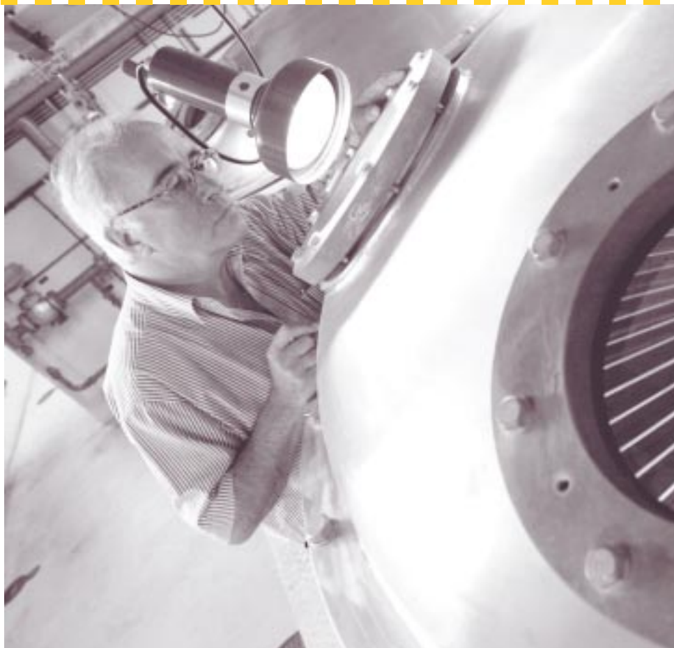
Jost Lisibach, Betriebsleiter Gartenbad St. Jakob, prüft die Anlage, die das Badewasser filtert.
